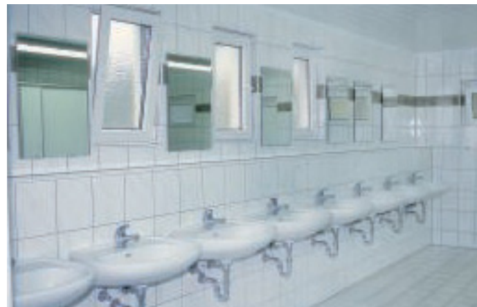
Kleinlich: Auch das fast unbeschädigte Sanitärgebäude mussten die Maschers auf Druck der Behörden kernsanieren.
