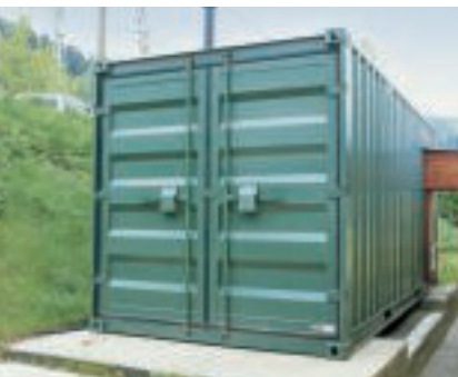
Clever: Dieser transportable Container beherbergt die gesamte Heizungs- und Solarthermieanlage.
